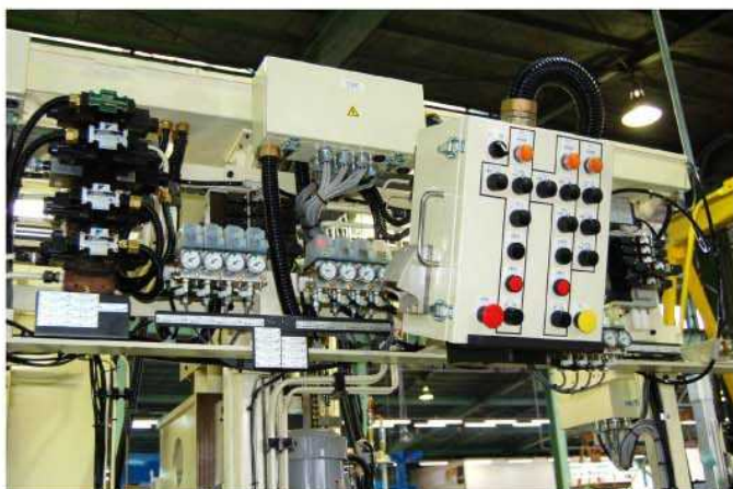
ステーション操作盤とエアー機器
