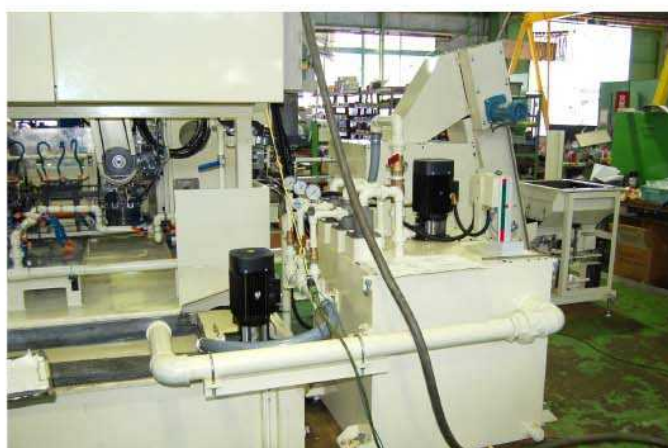
二次側クーラントユニット
